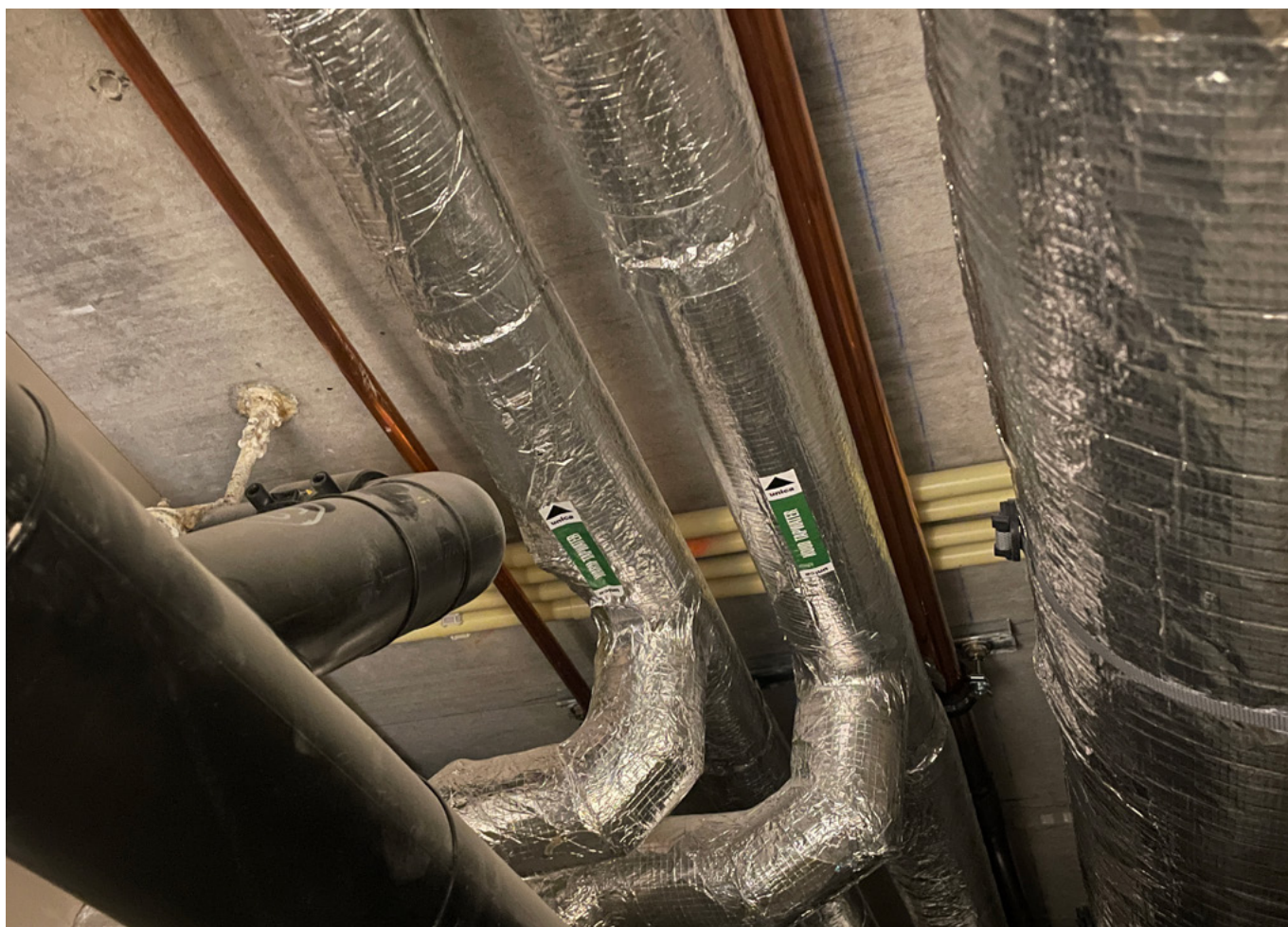
Foto 1: Boven verlaagd plafond links 28 mm warm water circulatieleiding met 22 mm isolatie, midden geïsoleerde koudwater circulatieleiding, in zwart riolerings.
